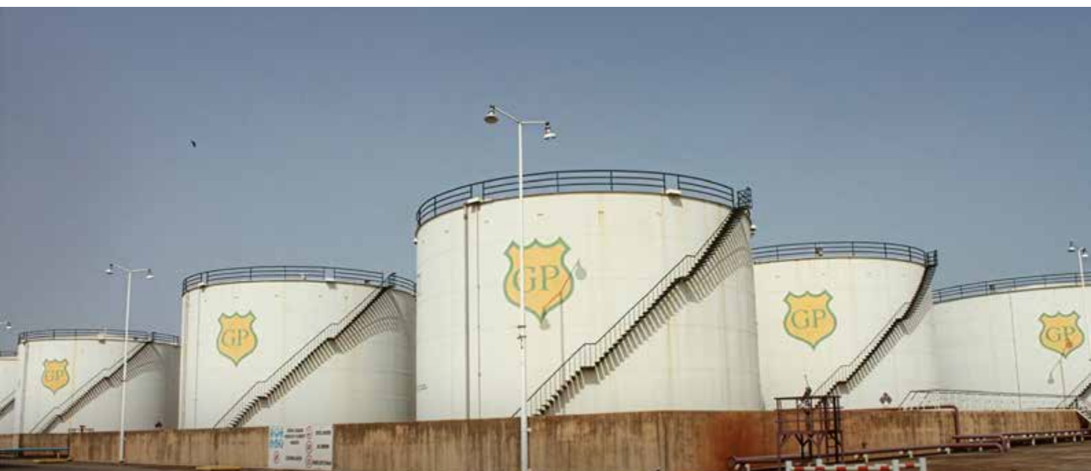
Das Ölterminal in Mandinari, in dem Totsa über Lagertanks verfügte.
